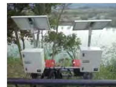
(左)傾斜計・ソーラー電源と接続 (右)伸縮計・ソーラー電源と接続
