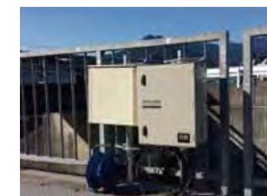
濁度計・商用電源と接続
