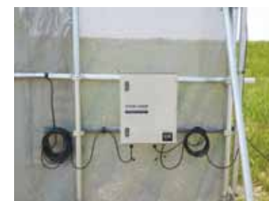
風向風速計・回転灯・ソーラー電源と接続
